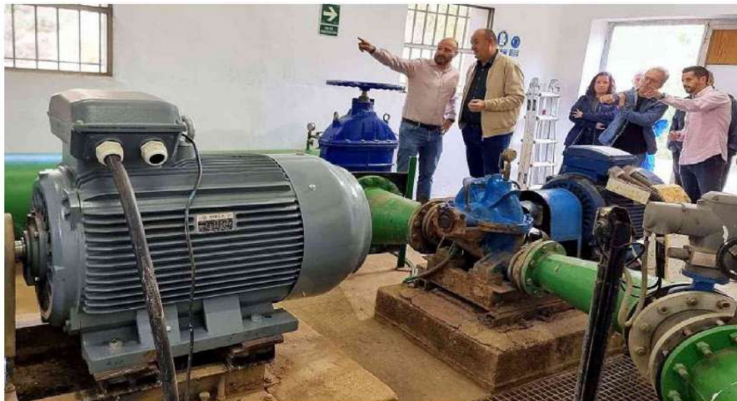
El concejal de Medio Ambiente, Gregorio Sánchez, visita los seis variadores de frecuencia instalados para mejorar la eficiencia energética de las bombas. / LT
